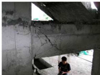
(d) Bi-directional shear cracks on "short beam"
