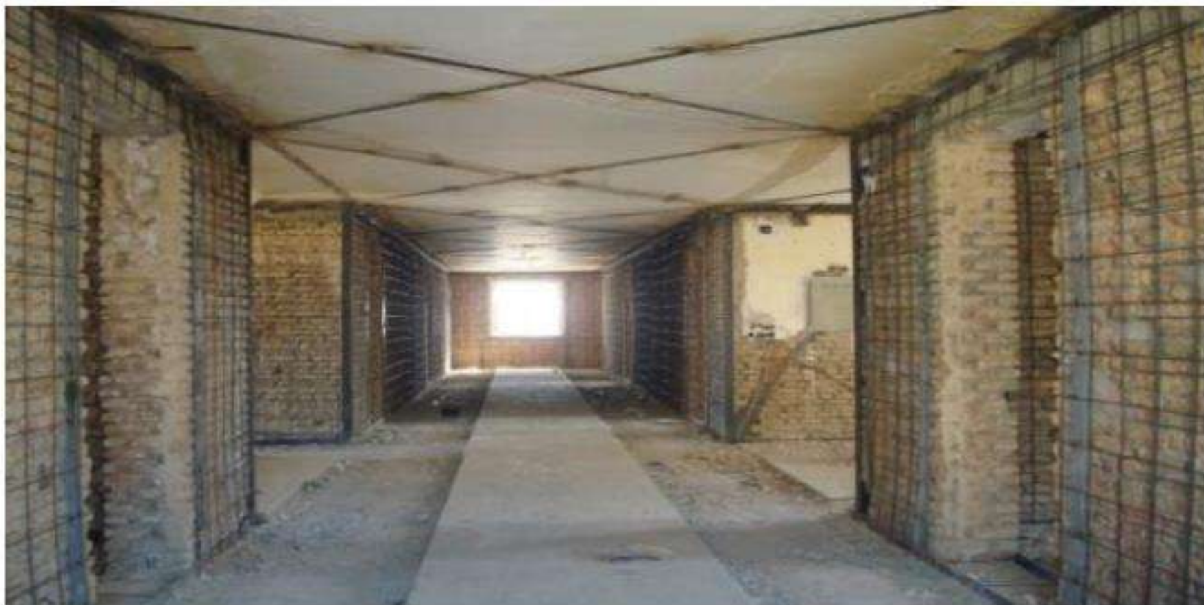
شکل ۲۱: نمونه ای از مقاوم سازی ساختمان آجری با سقف طاق ضربی
