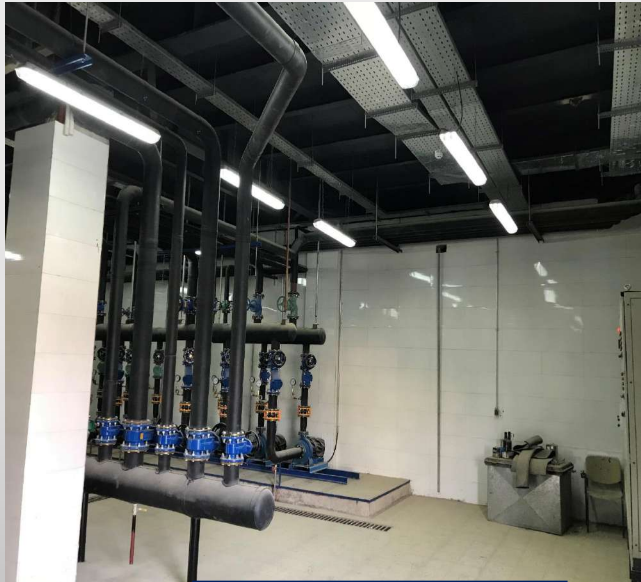
نصب چراغ زیر سینی های اصلی (زیر سقف موتورخانه)
