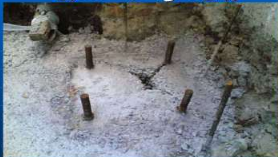
فضای خالی زیر کف ستون
