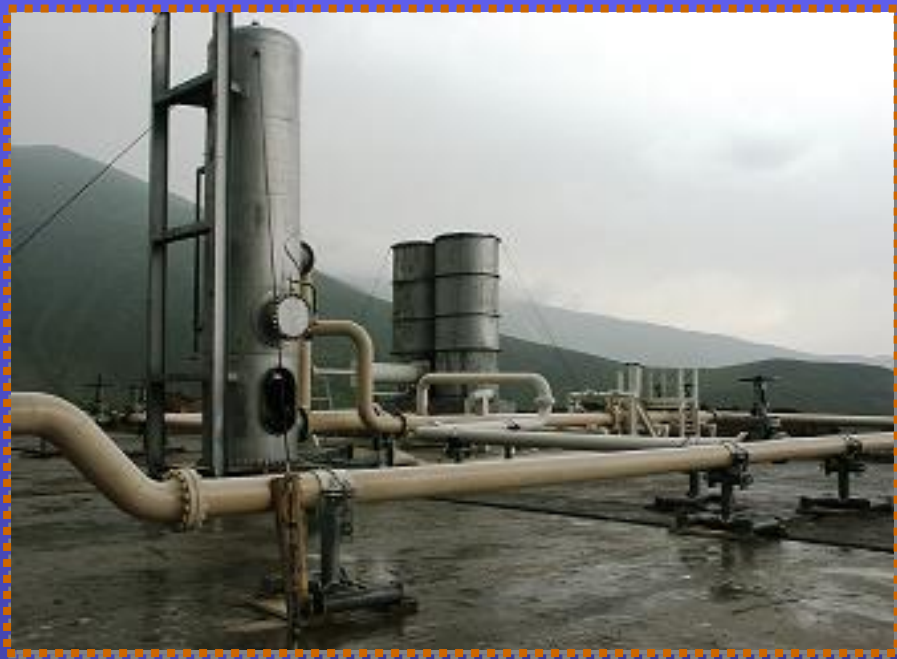
نیروگاه زمین گرمایی مشکین شهر
