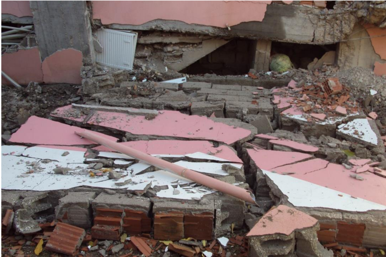
فرو ریختن دیوار آجری به دلیل عدم اتصال اصولی دیوار به قاب (زلزله ۲۳ اکتبر ۲۰۱۱ وان ترکیه)
